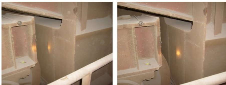
Obr.4. Porušené miesta po oprave
