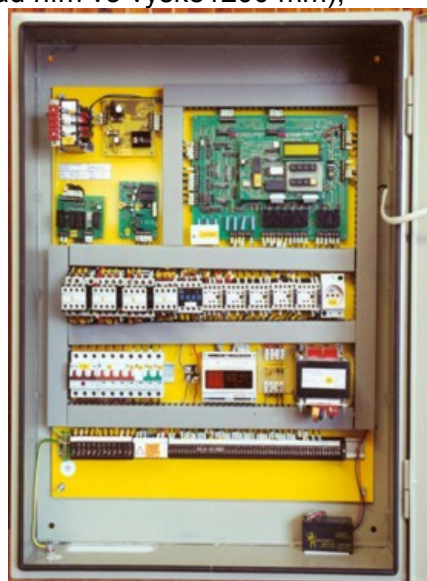
Obr.5. Riadiaci systém výťahu
