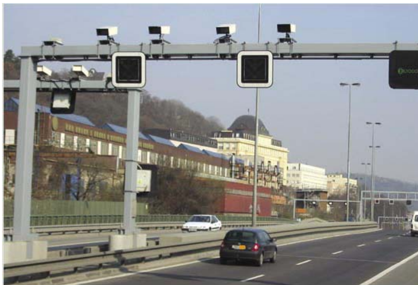
Obr.1. Portál s kamerovým systémem na čtyřproudové komunikaci (Camea)
